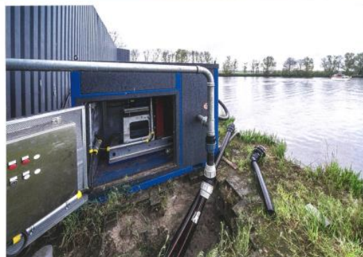
Twee zelfaanzuigende centrifugaalpomp (type 83B2 met 15kW motor) van Gorman-Rupp zuigen bluswater uit het kanaal voor de ringleiding rond het terrein van HSK Scrap Metals in Zwartsluis.
