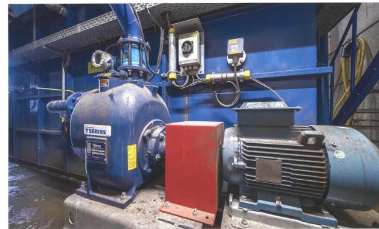
Deze Gorman-Rupp T4A6D5-B/PM venturipomp met 11 kW motor injecteert water in een waterfilter die het shredderstof opvangt. De pomp heeft geen moelste met stukjes blik of andere materialen die soms in het water zitten.
