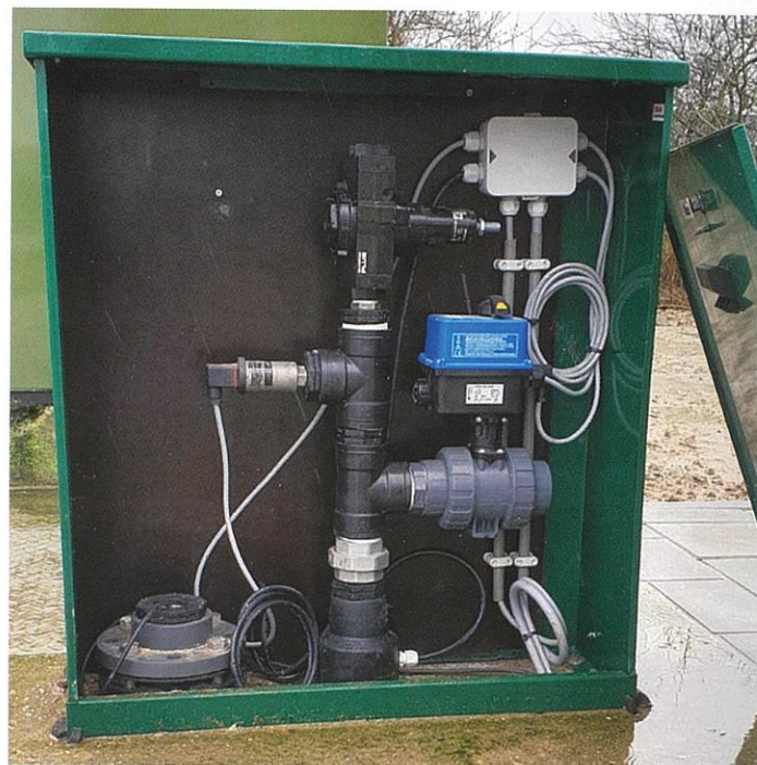
De besturingskast van het gemaal met de aansluitpunten voor de aanzuigleidingen in de put.
