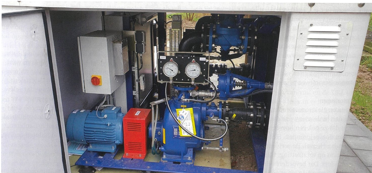
Het gemaal is van alle kanten goed bereikbaar door de openslaande deuren aan alle zijden van de installatie. De pompen zijn eenvoudig bereikbaar, en van buitenaf afstelbaar.
